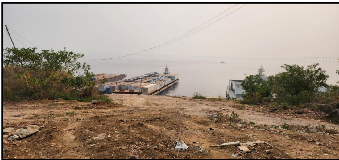
Área de fundos onde ficava o antigo atracadouro, atualmente em desuso pela estrutura estar quebrada e sem manutenção
