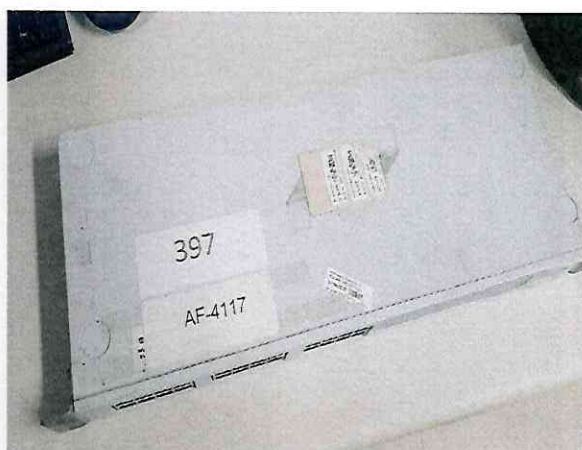
Foto 80 - Switch 3com de 24 portas
