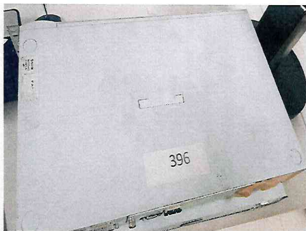
Foto 79 - Switch 3com de 24 portas.
