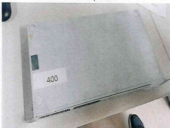
Foto 83 - Switch 3com de 24 portas
