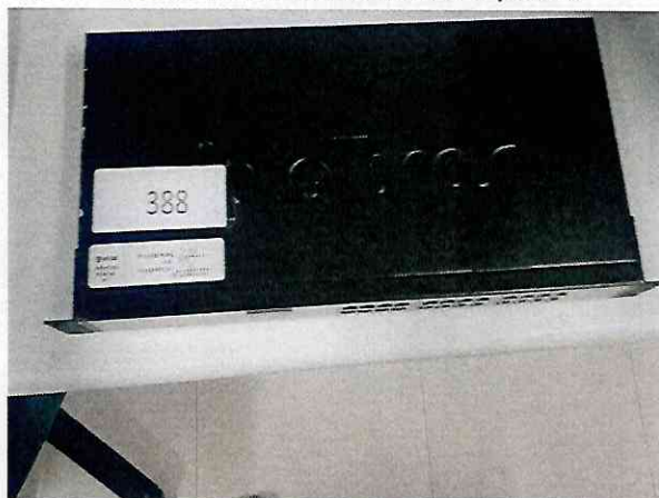
Foto 71 - Switch Intelbras de 24 portas
