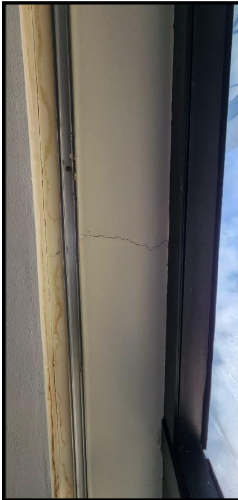
FISSURA NA SANCA ACIMA DA JANELA DO QUARTO
